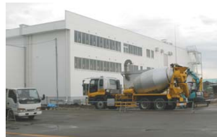
写真3(左) 竣工間近の第3工場(7月に竣工予定)。着々と工事が進められていた。ここでは主に工作用機器の組み立てが行われる。
